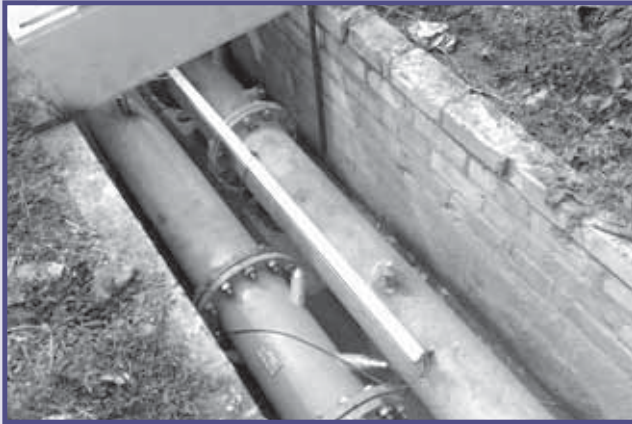
Теплолічильник з витратомірами діаметром 400 мм, встановлені за кошти Проекту USAID
