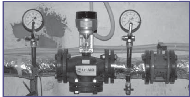
Система регулювання подачі теплоносія на системі опалення
